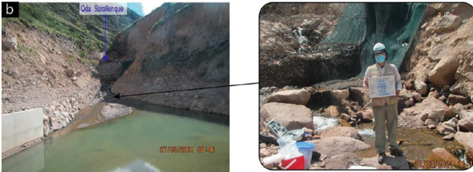
Figura 77. Malla de seguridad aldaño al punto de muestreo P-10A que evidencia actividad de remoción por AAQ. Nota. Tomado de OEFA (2021a, p. 243)
