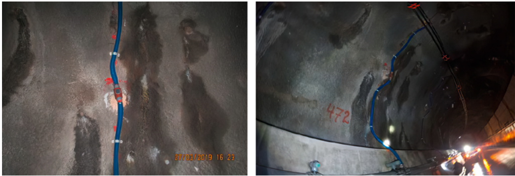
Figura 38. Zonas de filtraciones con flujos laminares a y goteos b al interior del túnel de derivación del río Asana. Nota. Tomado de OEFA (2019, p. 70)
