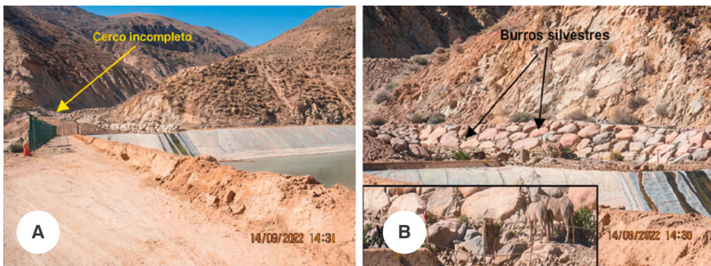
Figura 115. Vista de la poza 2000-PC- 07, en la que se observa que no contaba con cerco perimétrico que evite el ingreso de animales (a) y Vista de burros silvestres caminando cerca al borde de la poza 2000-PC- 07 (b) Nota. Tomado de OEFA (2022d, p. 31)
