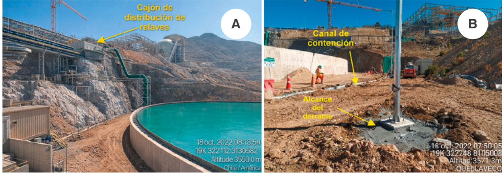
Figura 82. Vista del cajón de distribución de relaves de flotación desde donde ocurrió el derrame (a) y Vista del acceso perimetral del espesador N° 2 y canal de concreto en contacto con relave en el proceso de limpieza (b). Nota. Tomado de (OEFA, 2023b, p. 11)
