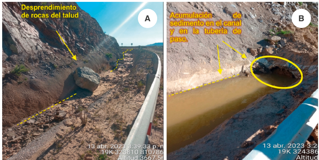
Figura 108. Vista del canal C-1, donde se observa la acumulación de sedimento, material suelto y rocas en su lecho (a) y vista del canal C-1, con acumulación de sedimento sobre el lecho del canal y dentro del caising (tubería de paso). Nota. Tomado de OEFA (2023c, p. 21)
